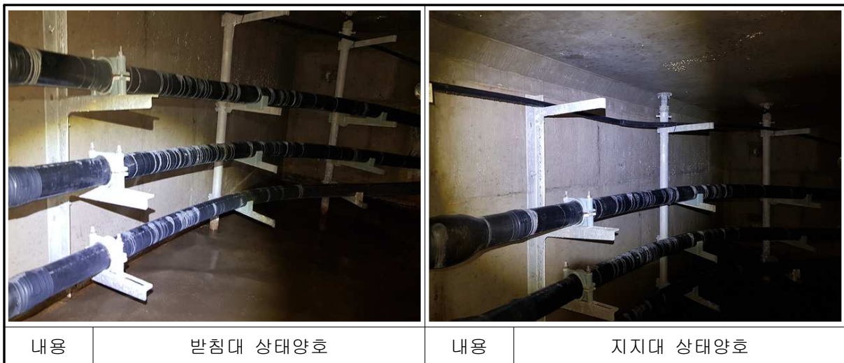
【사진 5.12】 부속 및 부대설비 현황
