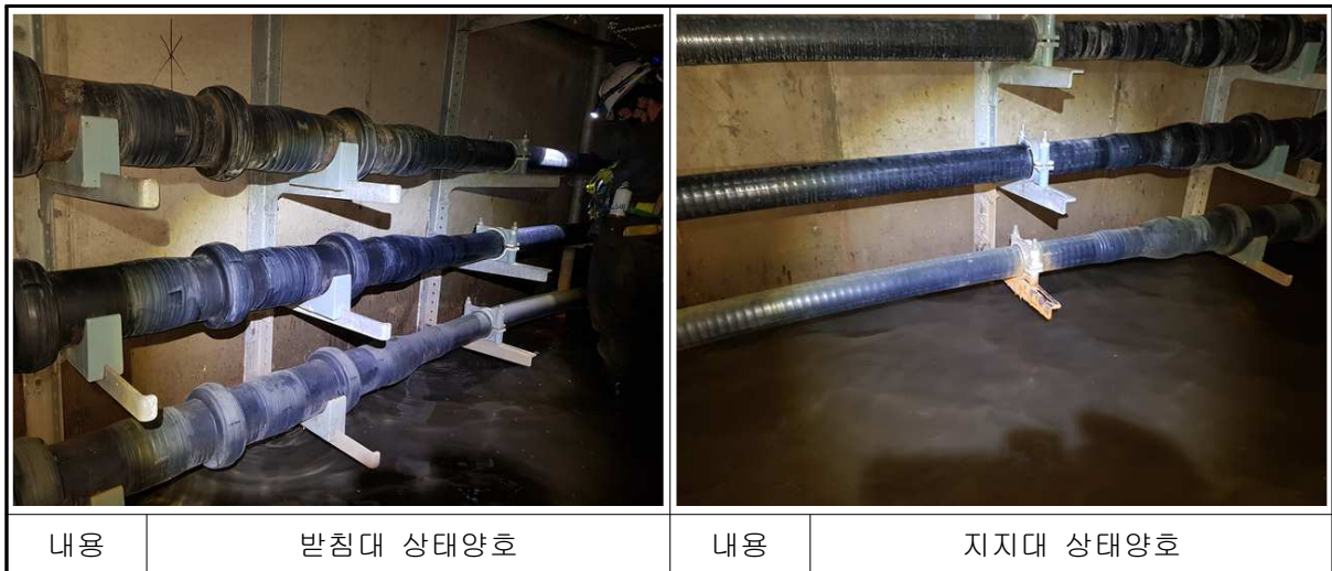
【사진 5.8】 부속 및 부대설비 현황
