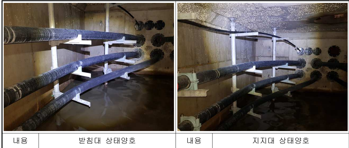
【사진 5.16】 부속 및 부대설비 현황
