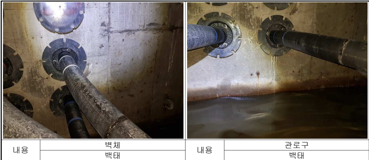
【사진 5.14】 맨홀 내부 주요 손상
